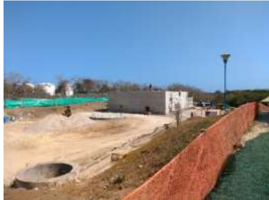
Foto 2. Área en donde se adelanta la construcción de la Planta de Tratamiento de Aguas residuales PTAR
